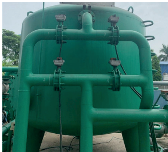
Bể tái chế nước thải hiện tại
